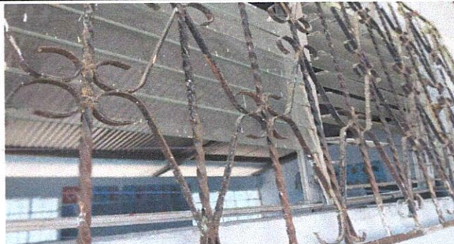
Foto 4: Esta son los ventanales dañados de un modulo que cubre dos aulas
