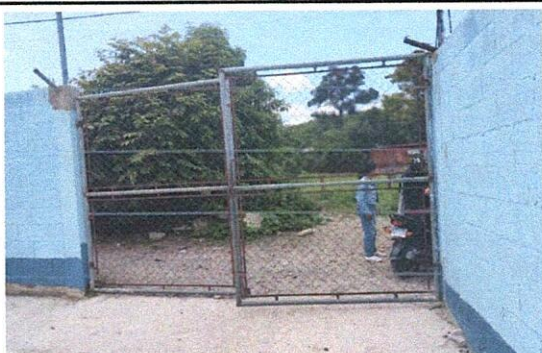
Foto 3: Este es el porton de acceso al establecimiento en mal estado.
