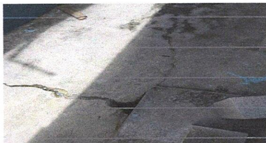
Foto 2: Este es el espacio donde esta la fosa dañada
